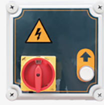
24V düşük voltajlı kontrol paneli
